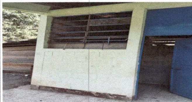
Foto 2: Sustrucción de vidrios
